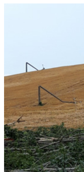
Poteaux HTA sur la commune de Plieux, juin 2023.
